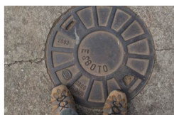
Caixas de Esgoto
