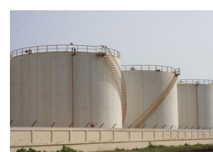
Tanques de armazenagem
